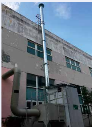
VOC(排ガス)処理施設
