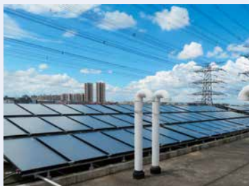
社員寮に設置した太陽熱パネル
