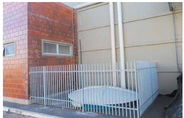
YBL(ブラジル)に設置された雨水タンク
